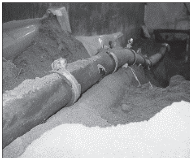
50cm 沈下時の管路変形状況
