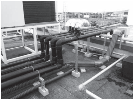
工場冷却水管
