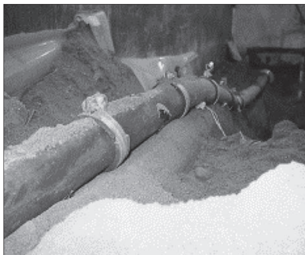
50cm 沈下時の管路変形状況
