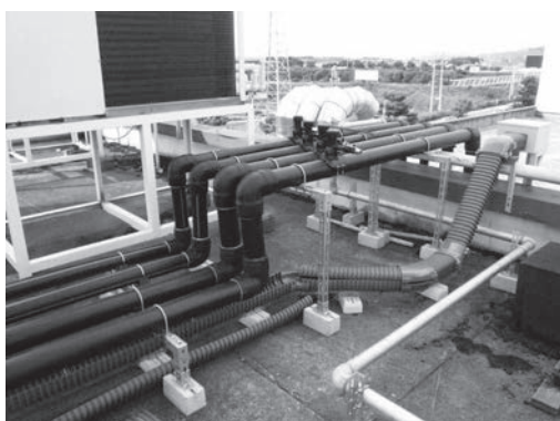
工場冷却水管
