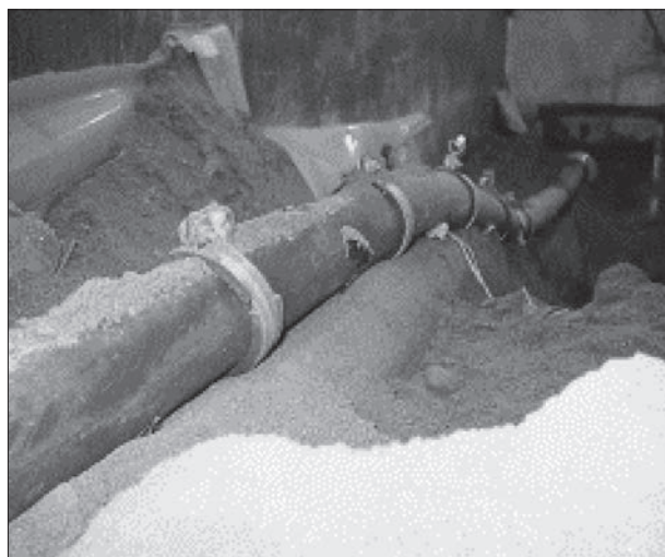
50cm 沈下時の管路変形状況
